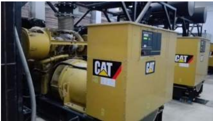
Fotoğraf 3. 78. 2 Adet 1875 kVA'lık Jeneratörlerin Genel Görünümü
