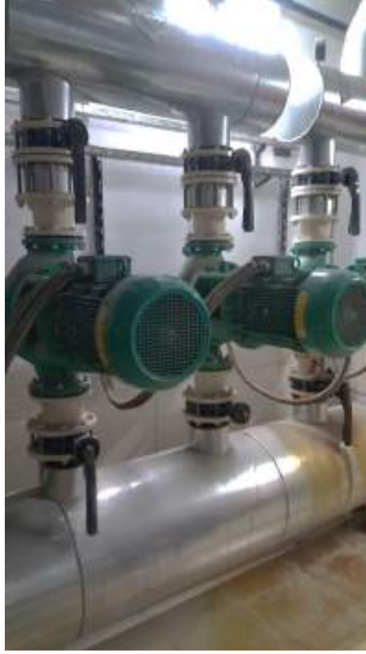
Fotoğraf 3. 84. Klima Santrali Zon-2 Isıtma Pompaları
