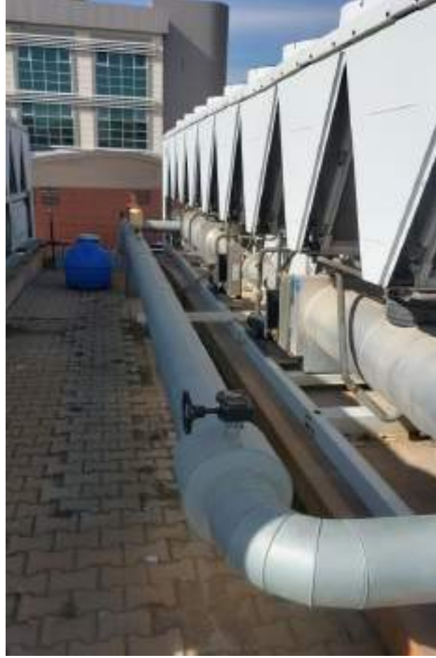
Fotoğraf 3. 47. Chiller Grupları Giriş Çıkış Vanaları
