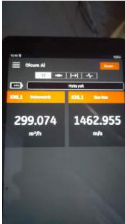
Fotoğraf 3. 48. Chiller 1-2 Grubu Debi Ölçümü
