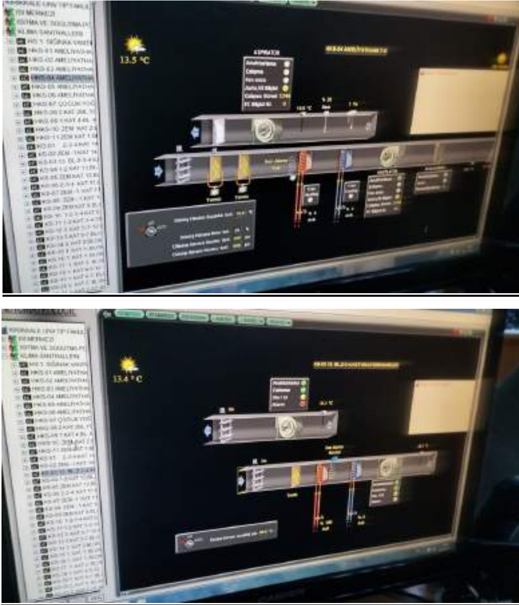
Fotoğraf 4. 1. Hastane Binası Klima Santralleri Otomatik Kontrol Görünümü
