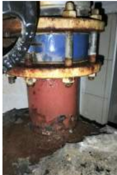
Fotoğraf 9. 2. Mekanik Tesisatta Paslanma Görünümleri
