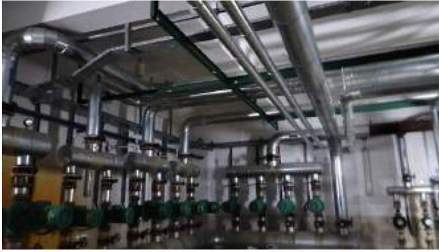
Fotoğraf 3. 58. Tesisat Genel Görünüm
