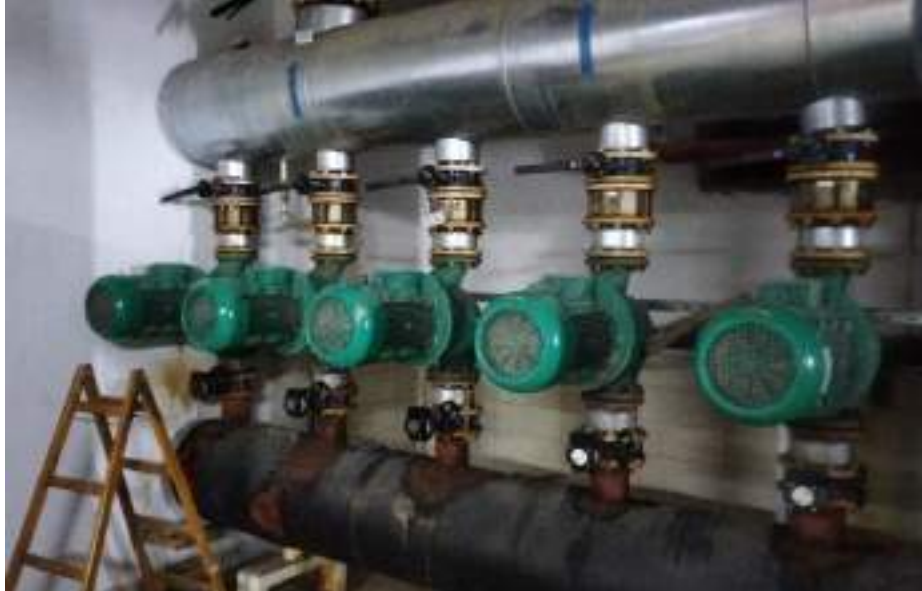
Fotoğraf 3. 85. Soğutma Grubu (Chiller) Sikülasyon Pompaları
