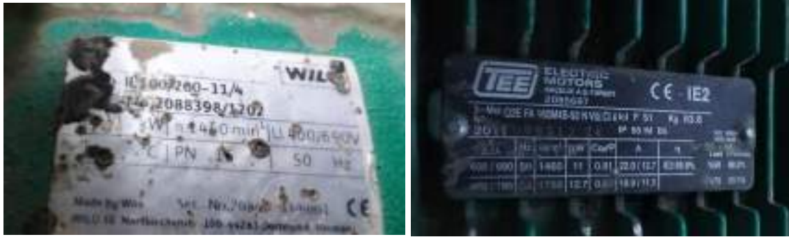
Fotoğraf 3. 86. Klima Santrali Zon-2 Isıtma Pompa ve Pompa Motoru Etiketi
