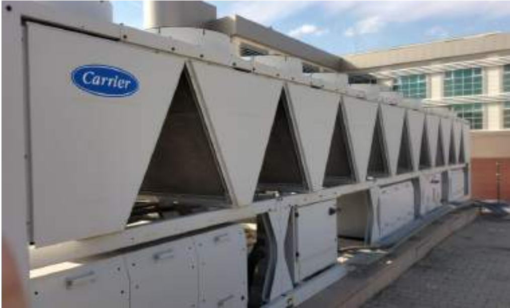
Fotoğraf 3. 45. Chiller Grupları Genel Görünümleri
