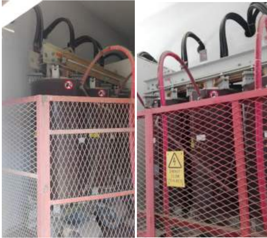
Fotoğraf 3. 75. 2 adet 2500 kVA'lık Trafoların (TR-1 ve TR-2) Genel Görünümleri
