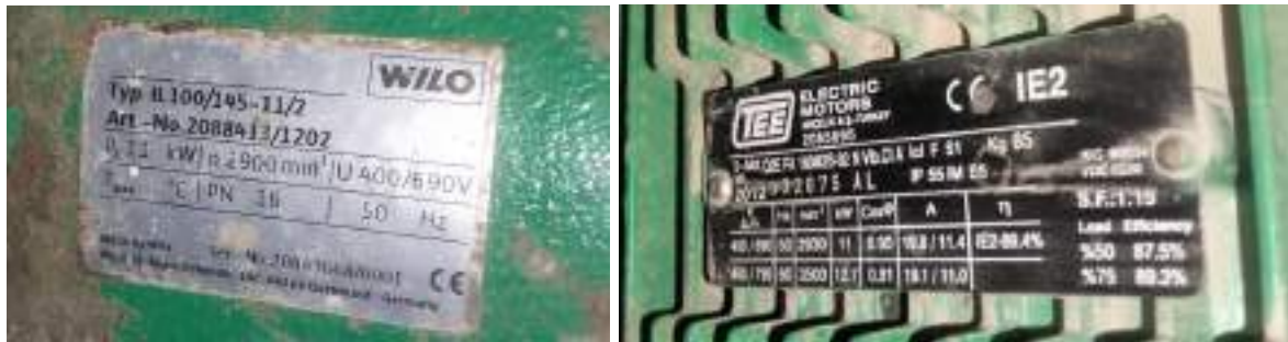
Fotoğraf 3. 87. Soğutma Grubu (Chiller) Sirkülasyon Pompa ve Pompa Motoru Etiketi
