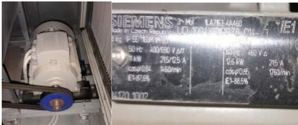
Fotoğraf 3. 93. KS-2 14.Blok Zemin, 1.Kat Muayeneler KS Vantilatör Motoru ve Etiketi
